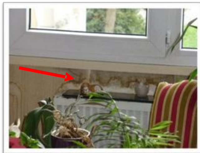
Traces d'infiltrations d'eau sous les fenêtres
