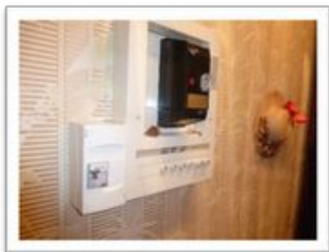
Installation électrique avec fusibles
